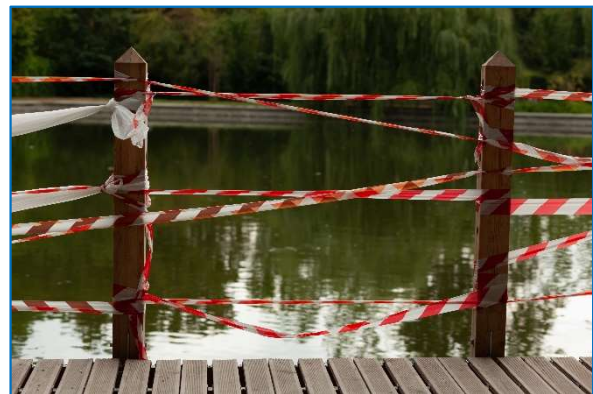
Achterstallig onderhoud kan tot gevaarlijke situaties aan het viswater leiden
